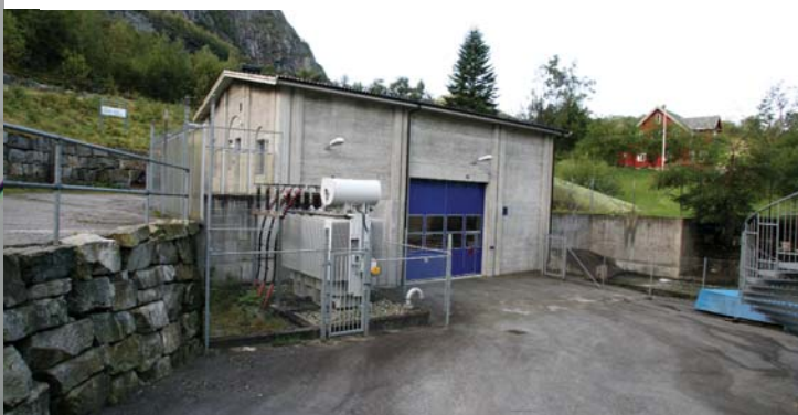
Den nye kraftstasjonen som åpnet i 1994 har et beskjedent ytre. Men kreftene som blir ført herfra og inn til transformatoren i bygget ved siden av er alt annet enn beskjedne, selv om dette er et av de små kraftverkene til Lyse.
