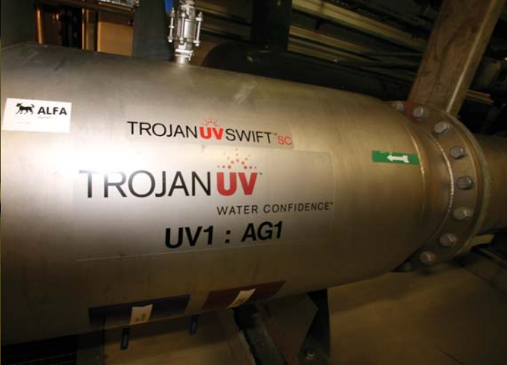
Inni dette røret er det montert lysrør som belyser vannet med UV-stråler. Det dreper sporer og bakterier.
