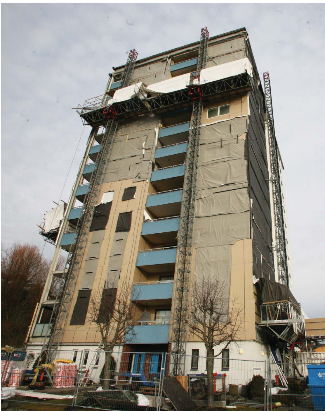
Nye byggeforskrifter og beregningsregler gjør at de gamle konstruksjonene ikke var tilstrekkelige for de tre blokkene i Gandsfjord borettslag.
